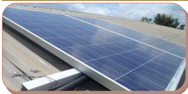
Les panneaux solaires installés
